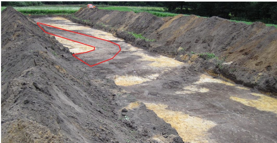
Figuur 19. Pesse, Oostering – Toekomstige Ijsbaanlocatie. Een overzichtsfoto van werkput 31 genomen in zuidoostelijke richting. De grote donkere verkleuringen bestaan uit zowel recente verstoringen als uit archeologisch relevante sporen. De greppel of sloot (s3044), die vermoedelijk als afscheiding van een akker gediend heeft, is met rood omlijnd.
